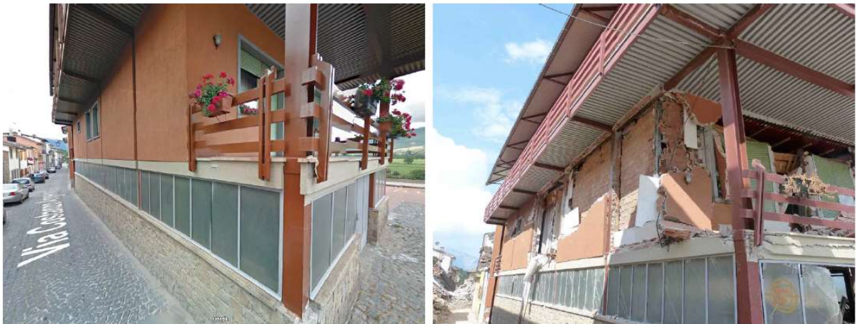
Figura 2 Amatrice: risposta in piano e fuori piano degli edifici in acciaio, delle pareti di tamponamento e delle vetrate; danni rilevati nell'edificio in acciaio e immagine GSV prima dell'evento.
