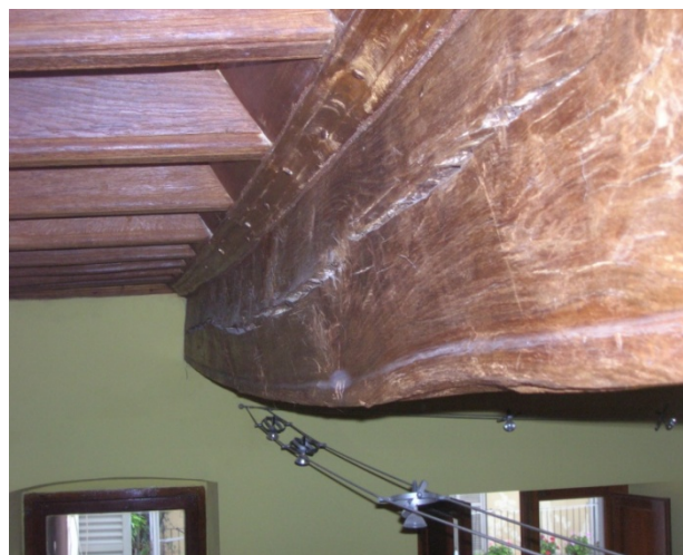
Foto 2: Trave in legno fessurata longitudinalmente
