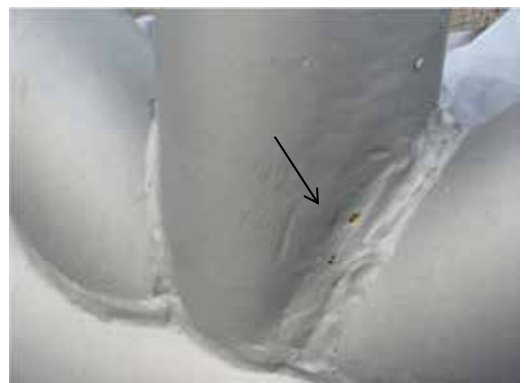
Porosità riscontrata con controllo visivo
