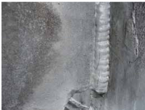
Cricca sul cordone riscontrata con MT
