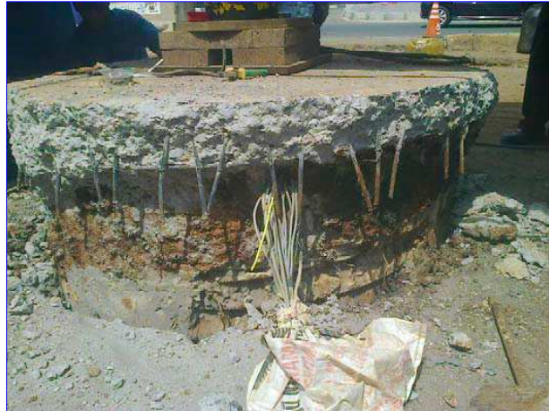
Fig. 12 Palo scavato per mettere in luce il difetto
