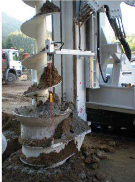
Fig. 4.3.2.1 – Fuoriuscita del calcestruzzo mentre l'elica è ancora nel terreno
