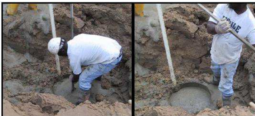
Fig. 5.6.2 – Rimozione del calcestruzzo che si è mescolato al terreno
