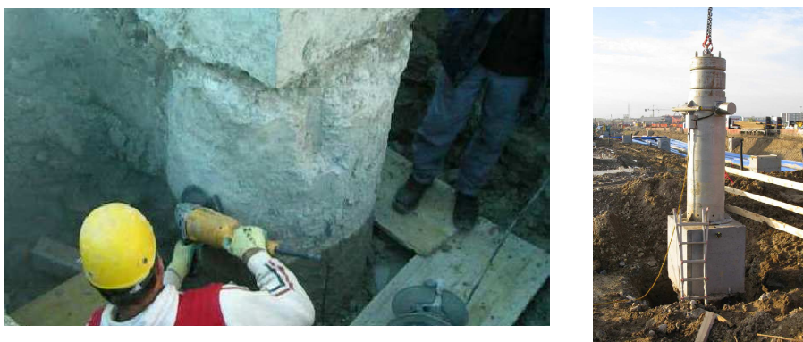
Fig. 9.4.1 – A sinistra preparazione della testa del palo, a destra posizionamento del dado in calcestruzzo armato
