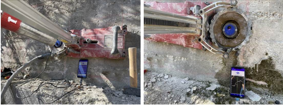
Figura 13: Tensometer su spalla in c.a.
