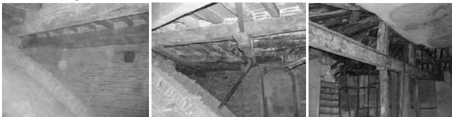
Figura 21. Viste della cupola in muratura, del solaio "ad anello" e delle capriate lignee di copertura puntellate.
