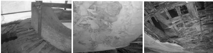
Figura 22. Oculo della cupola in muratura con la vela in cannicciato e il supporto in avanzato stato di degrado.
