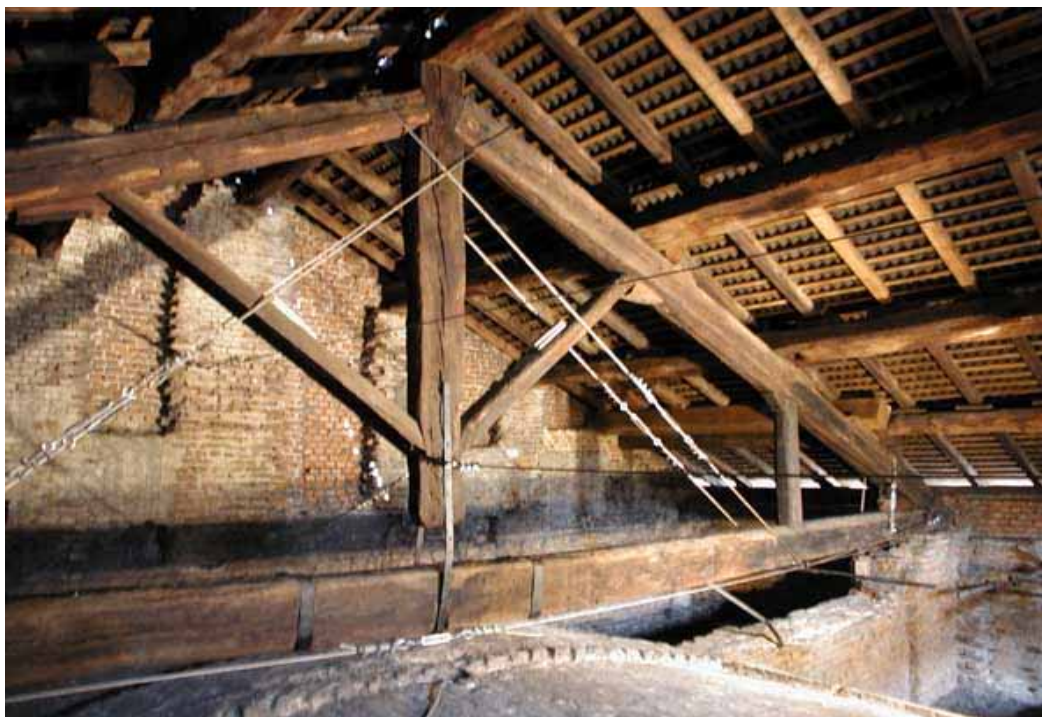
Figura 24. Intervento di consolidamento degli appoggi e delle capriate mediante cavi esterni post tesi, con inserimento di un nuovo puntello ligneo di contrasto della falda
