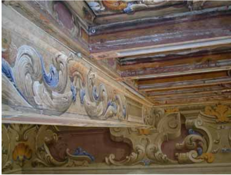
Figura II. 6 Vista intradossale di solaio in legno con trave primaria costituita da coppia di putrelle rivestite da foderina lignea decorata
