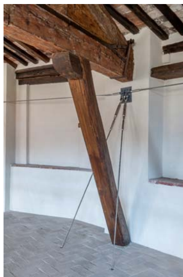
Figura 12. Tiranti a "V" rovescia posizionati sopra il solaio di sottotetto, ancorati all'imposta del tetto
