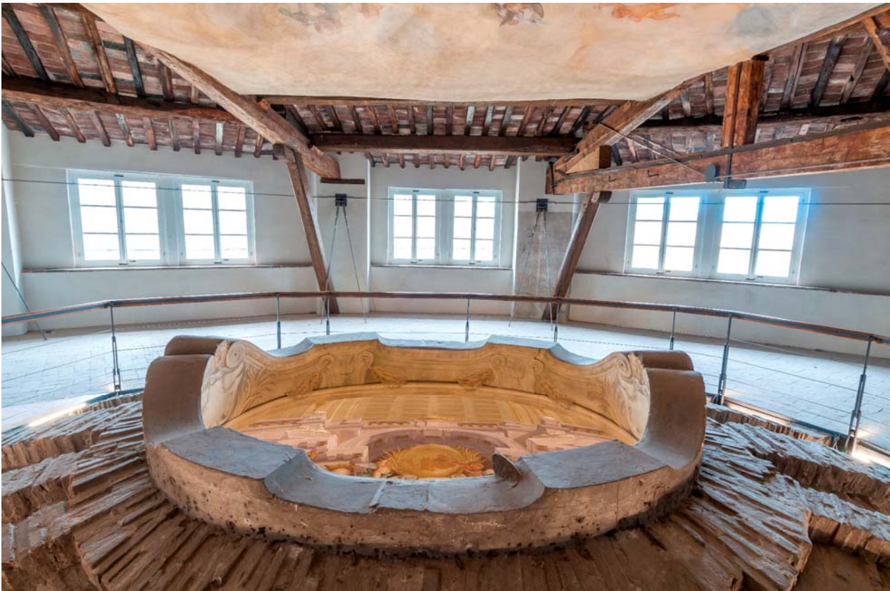
Figura 25. Vista interna al sottotetto: in primo piano l'oculo riaperto, in secondo piano gli interventi di consolidamento.
