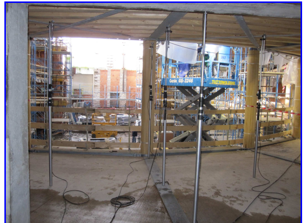
Foto 8: Sensori per rilevare le deformazioni in tempo reale
