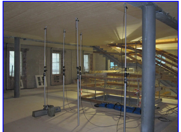
Foto 6: Sensori per rilevare le deformazioni in tempo reale
