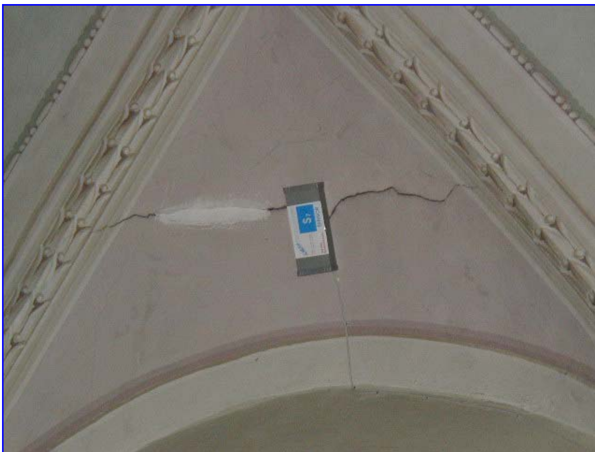
Vista di una fessura della volta
