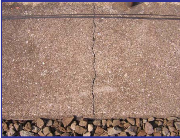
Foto 9: fessura trasversale sulla soletta
