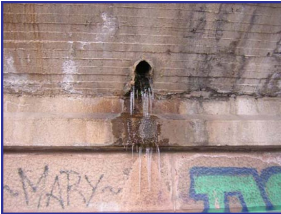
Foto 3: macchie di umidità e scarico rotto
