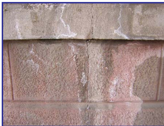
Foto 2: fessura verticale spalle
