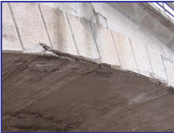
Foto 5: armatura ossidata arco
