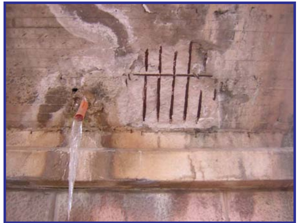
Foto 6: armatura ossidata arco
