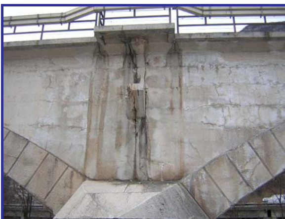
Foto 7: fessure longitudinali e verticali
