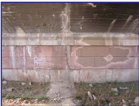
Foto 1: macchie di umidità attiva spalle
