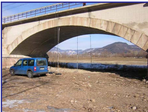
Trasduttori di spostamento II campata
