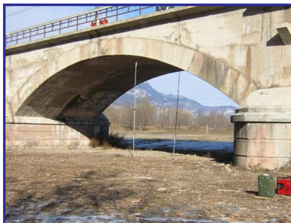
Trasduttori di spostamento III campata
