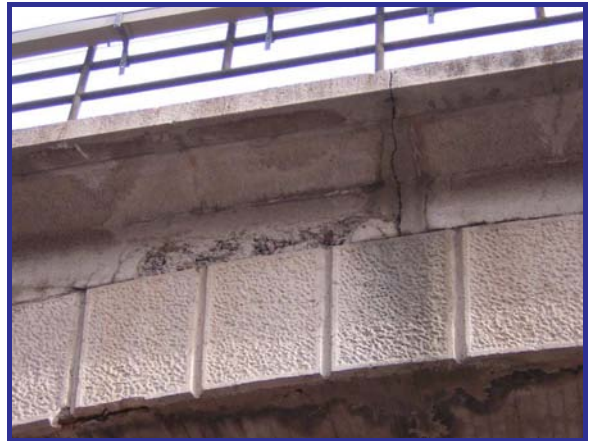
Foto 4: vespai zona timpano e fessure
