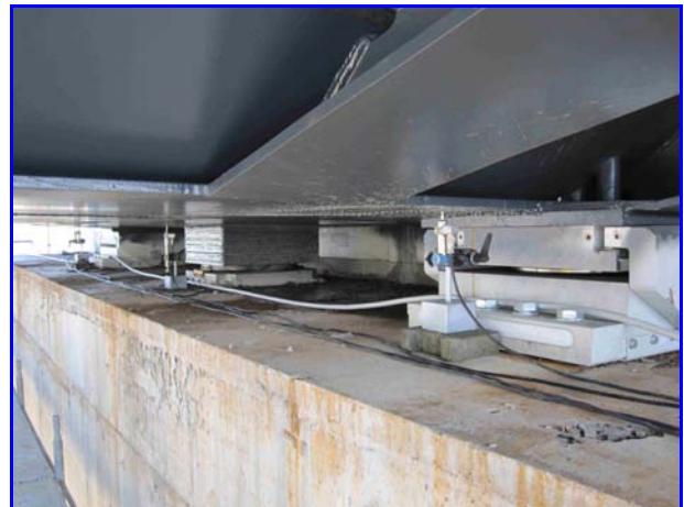
Foto 4: Sensori spalla est (CH10÷14)
