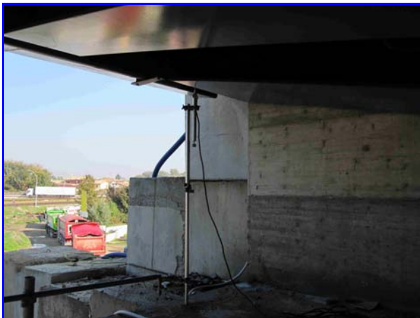
Foto 3: Sensore spalla est (CH10)
