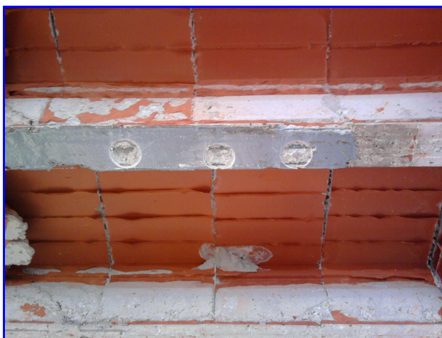
Foto 15: Intradosso del travetto indagine D
