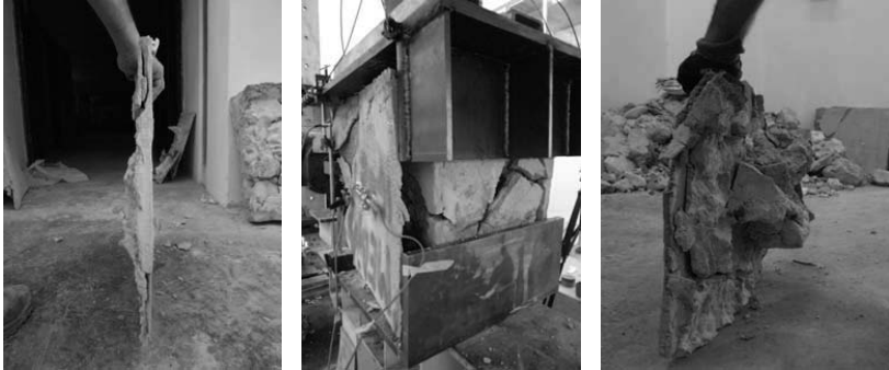
Figura 11 : Delaminazione dello strato superficiale rinforzato con fibre di acciaio G4 (sx), G12 (centro) e con fibre di basalto (dx)
