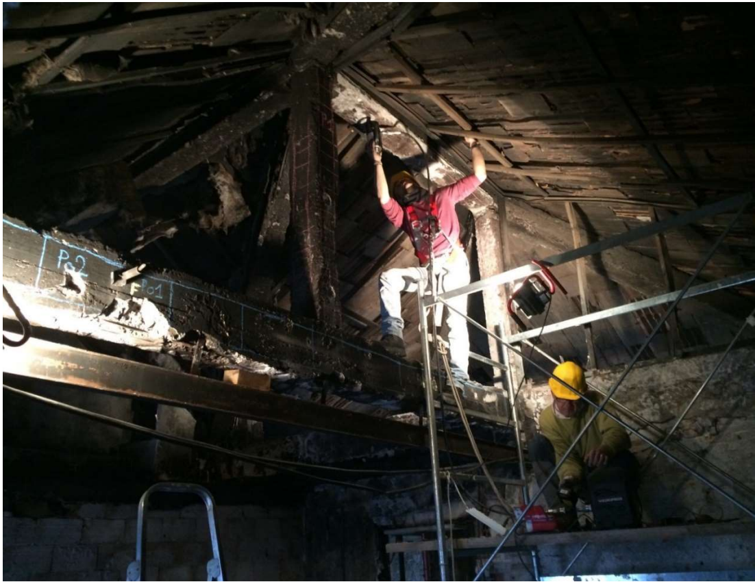
Figura 9: Effetti distruttivi di un incendio domestico, si notino gli operatori che eseguono prove di pull-out.
