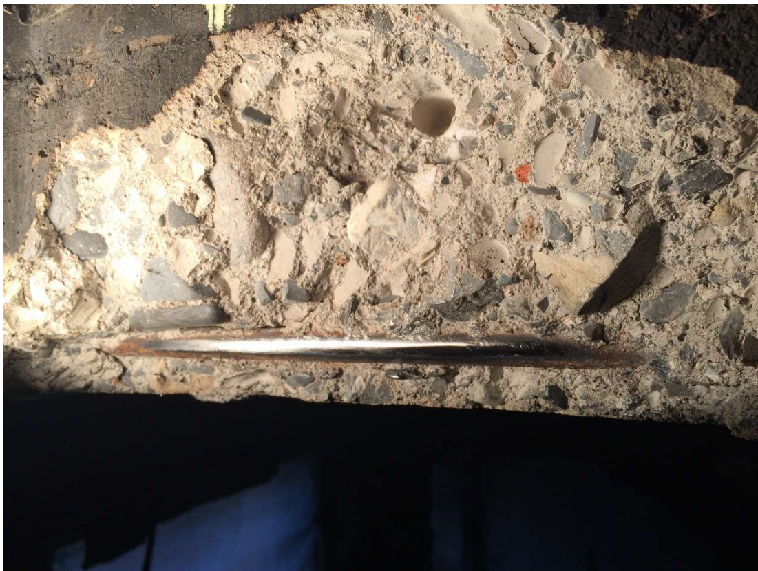
Figura 11: Superficie di un ferro d'armatura parzialmente affiorante levigato, pronto per prova di durezza. Si noti il foro lasciato da una prova di pull-out.
