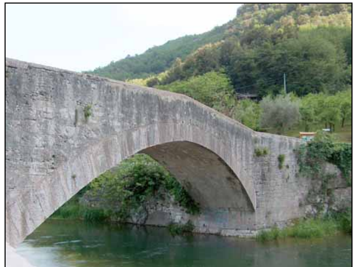
Tipico ponte ad arco romano in pietrame: esempio di cultura della “compressione”
