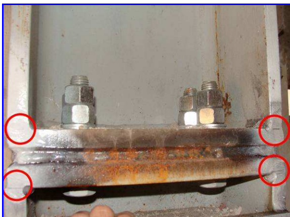
Mancanza di penetrazione tra piastra e trave
