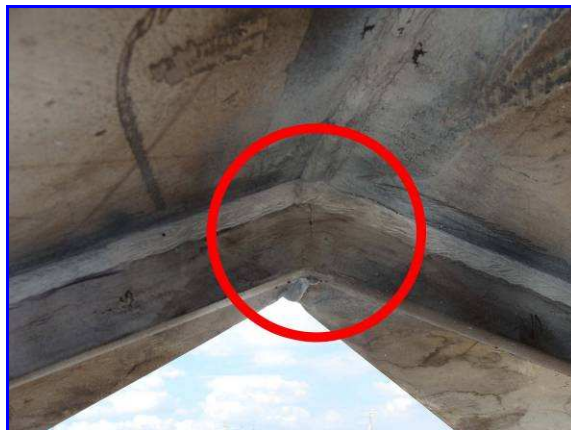
Mancanza di penetrazione nella piastra
