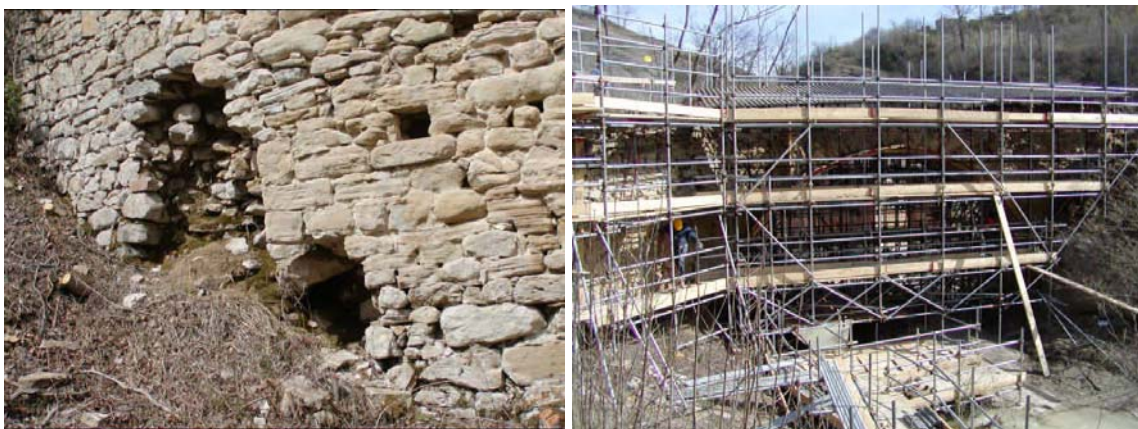
Figura 35. Situazione precedente l'intervento di presidio e struttura provvisoria di presidio in fase di allestimento
