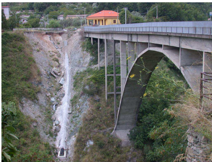
Figura 13: Frana del 2010 e cedimento dell'impalcato
