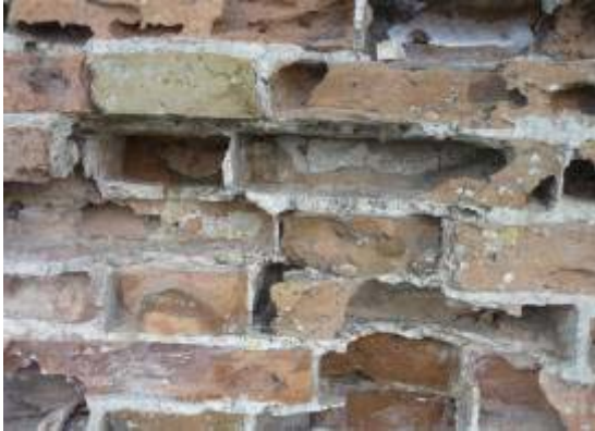
Fig. 9: Vista dei deterioramenti nella Rocca di Castrocaro
