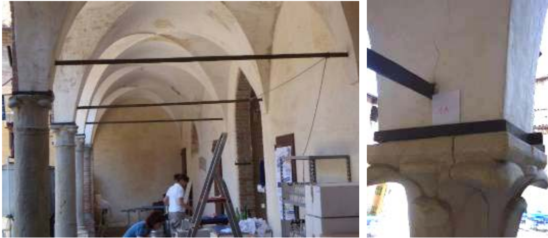
Fig. 18: Vista laterale del porticato e del capitello fessurato
