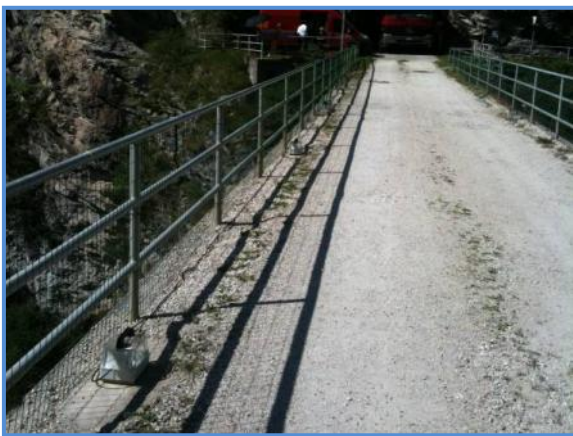
Posizione dei sensori inclinometrici
