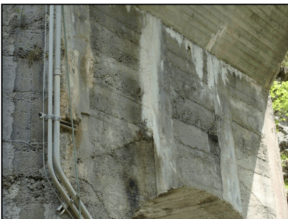
Foto 3: presenza di vespai sulle spalle.
