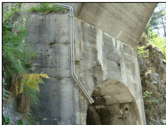
Foto 2: il calcestruzzo delle spalle risulta dilavato.
