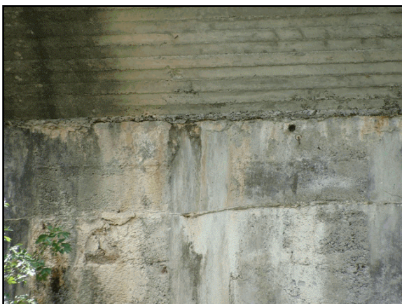
Foto 1: si notano macchie d'umidità su entrambe le spalle.
