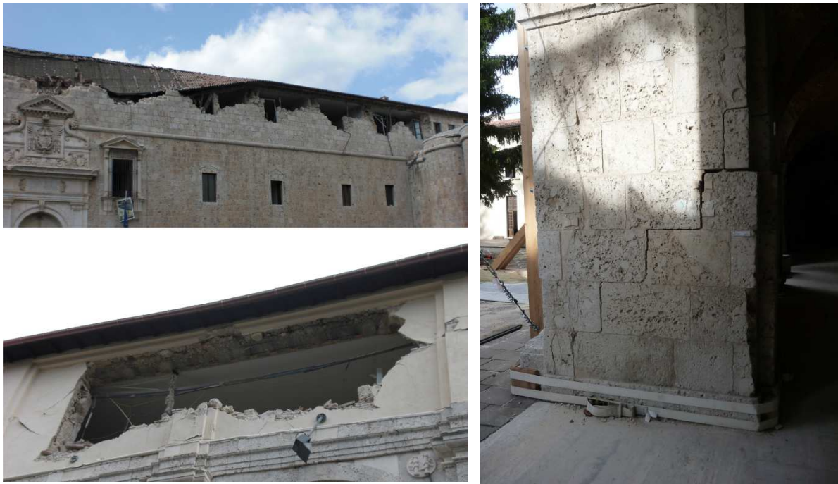
Figura 6 – Danni subiti dalla Fortezza in seguito al sisma del 6 Aprile 2009
