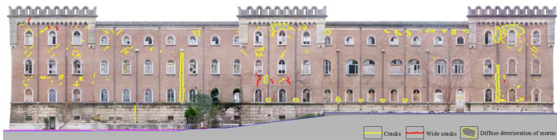
Figura 18 Vista del quadro fessurativo del prospetto Nord del castello
