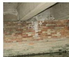
Foto 3: in una zona sulla muratura della spalla destra tra le II e III trave da valle si rilevano delle efflorescenze.
