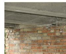
Foto 4: in una zona delle spalle sinistra sotto la II trave da monte si osserva la polverizzazione dei giunti di malta fra i conci di muratura.
