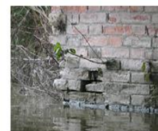
Foto 2: alla base su entrambi i bordi di monte delle spalle si notano porzioni di muratura mancanti.
