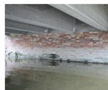
Foto 1: su tutta la metà inferiore delle spalle sono visibili macchie di umidità.
