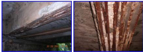
Distacco del copriferro ed armatura corrosa
