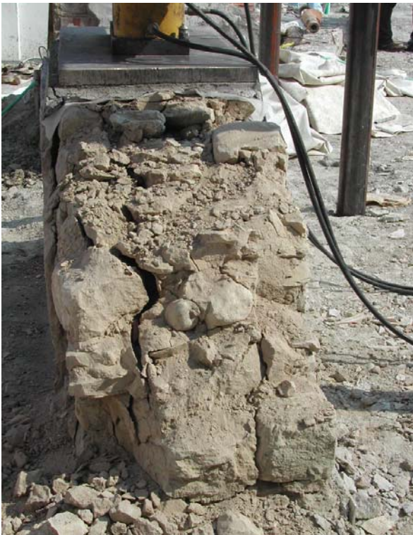
Figura 6. Prova n.1: fessurazione avanzata
