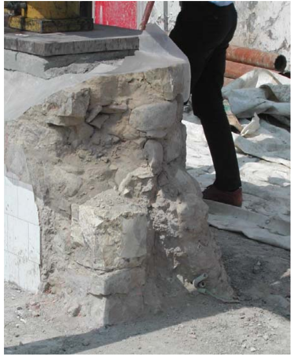
Figura 5. Prova n.1: fessurazione incipiente
