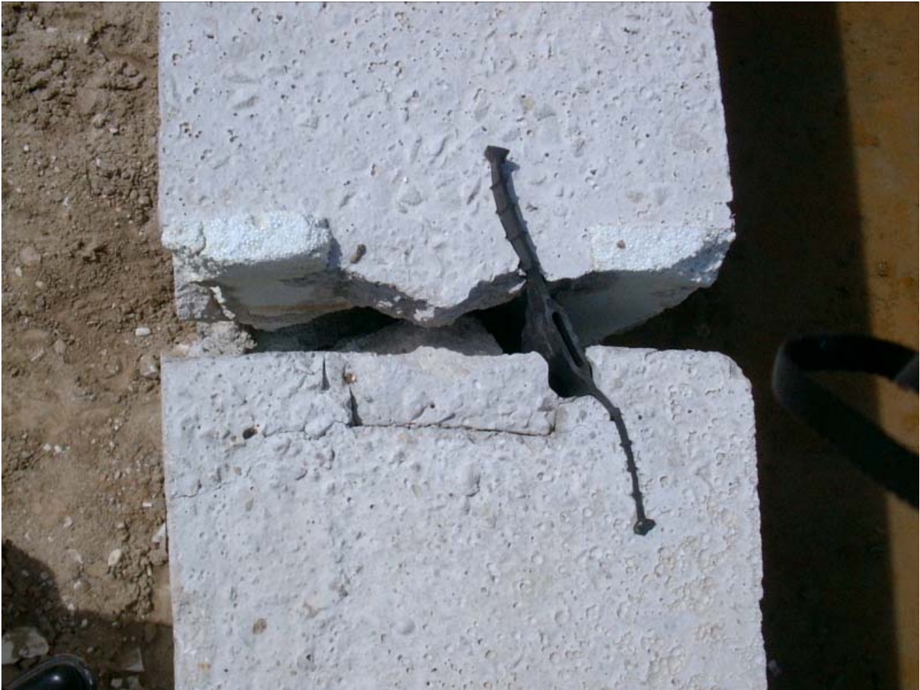
Illustrazione 3: Giunto waterstop su vasca reflui in assenza di armatura lenta passante Catena degli eventi:
