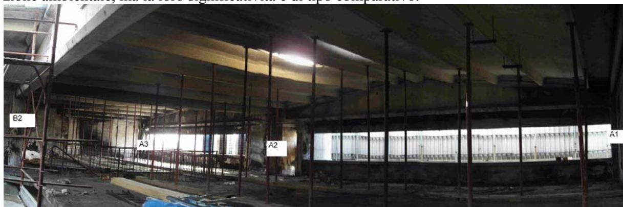
Figura 34, Impalcato con travi a doppia pendenza e tegoli prefabbricati in c.a.p. danneggiato da incendio [archivio dell'Autore].
