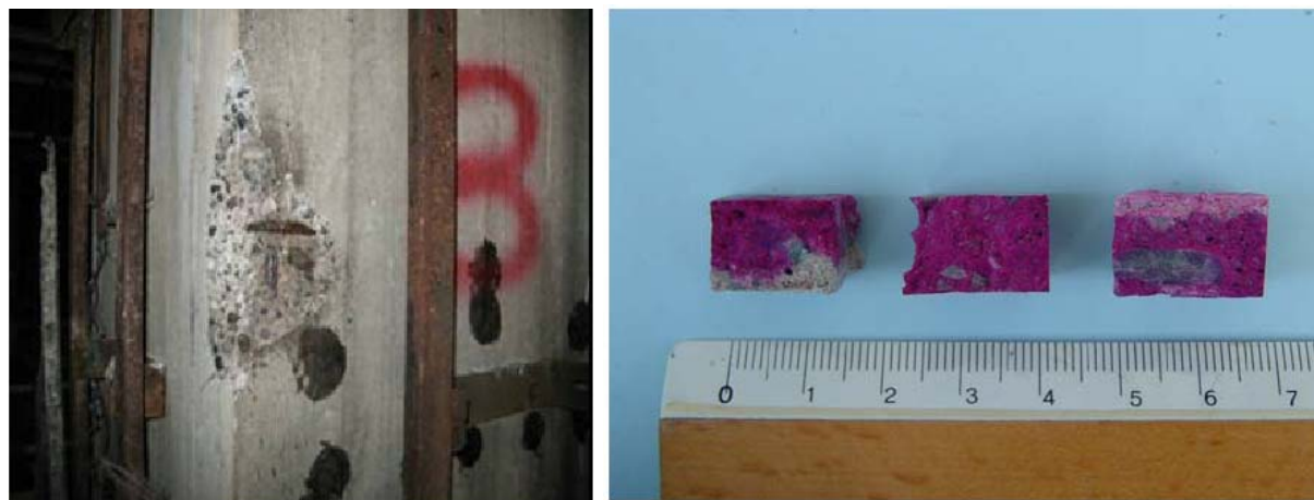
Figura 32. Reazione con fenolftaleina: a sinistra calcestruzzo carbonatato, a destra calcestruzzo ancora basico.
