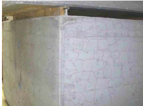
Figura 13 – evidenziazione del percolamento attraverso il contenitore modulare.
