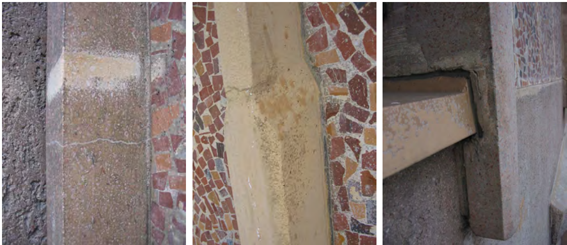
Figura 12: Fessura in corrispondenza di un'armatura in corrispondenza di un intervento precedente
