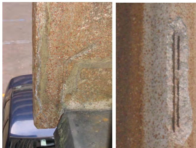
Figura 13: Lesioni e distacchi del copriferro
