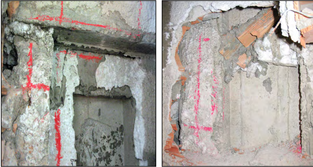
Figura 7: Rilievi delle armature evidenziate dal pacometro
