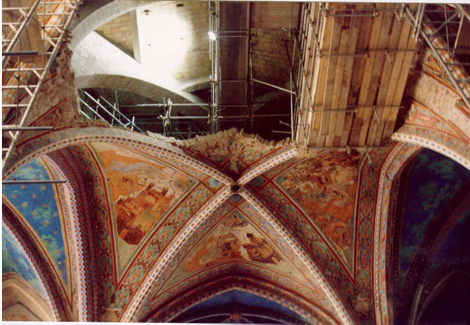
Figura 9 – Colapso parcial de una bóveda de la Basílica de Asís en Italia, provocada por el terremoto ocurrido en 3 de noviembre de 1997. El colapso provocó la pérdida de decoración original de altísimo valor artístico.
