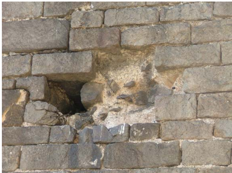
Figura 6 – Daño producido por un proyectil en los muros exteriores de la Basílica de Santa María del Mar en Barcelona, durante la Guerra de Sucesión. Ejemplo de alteración que debería mantenerse como parte de la historia de la propia construcción.
