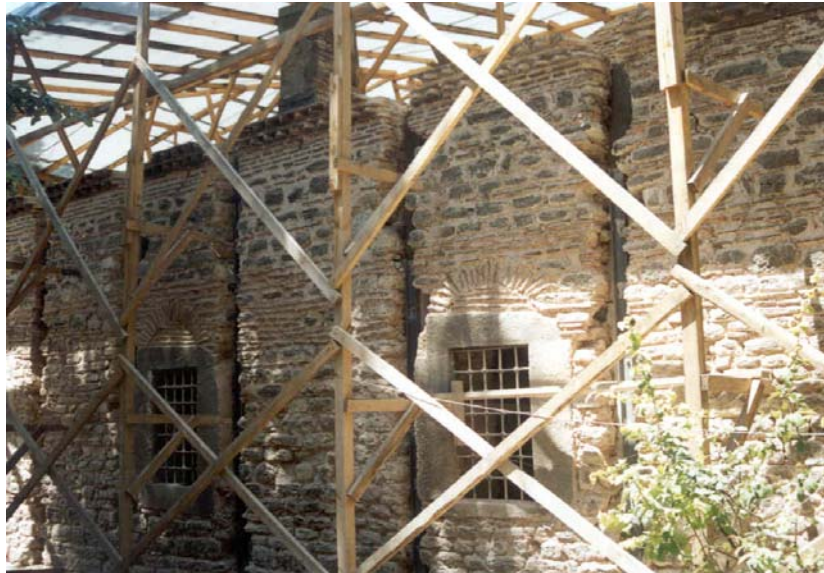
Figura 10 – intervenciones de muy alto coste en forma de pérdida de valor cultural irreversible debido a una excesiva alteración de los materiales y estructura originales. Las bóvedas y arcos de la fotografía superior fueron revestidos con hormigón proyectado tras la colocación del refuerzo observable.
