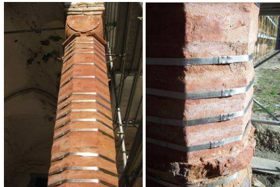
Figura 37 e 38: cerchiatura delle colonne del chiostro dell'ex Monastero di Santa Monica a Cremona.
