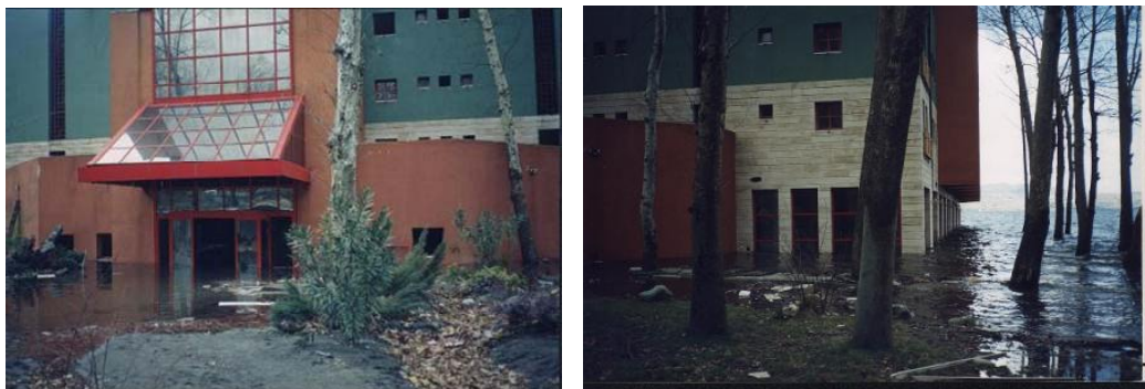
Figura 15. Lateral spreading di un albergo in prossimità del lago di Sapanca durante il terremoto di Kocaeli del 1999 in Turchia.
