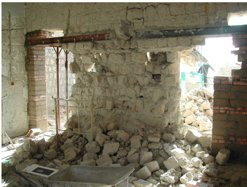
Figura 9. Lo stato del muro di spina dopo il crollo
