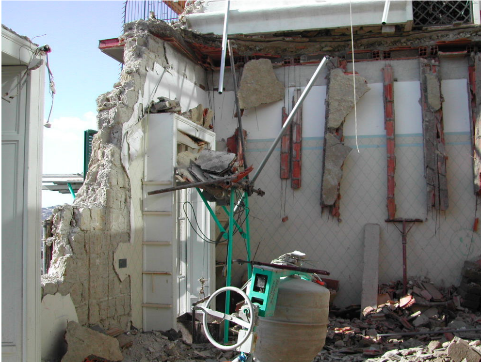
Figura 6. Il solaio e la facciata esterna crollati
