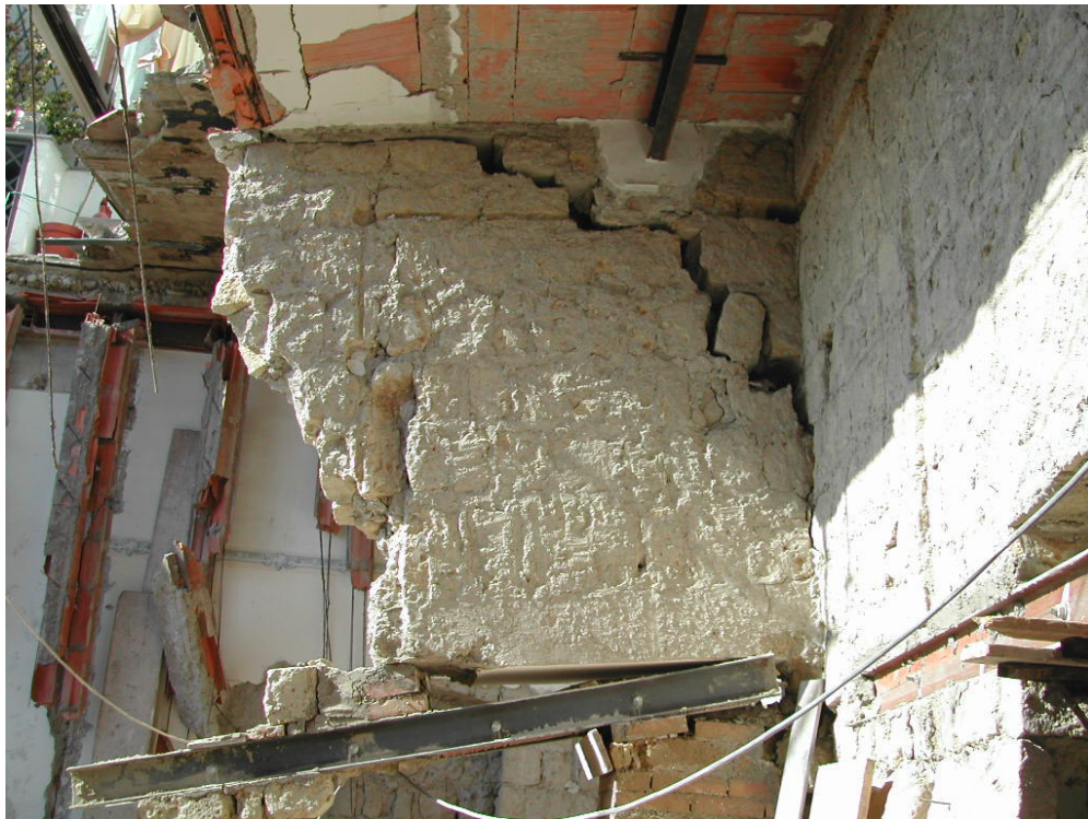
Figura 8. Particolare del muro trasversale crollato
