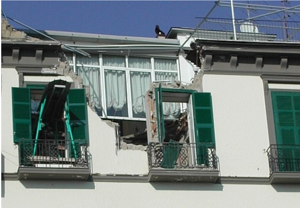
Figura 4. Prospetto esterno crollato; in secondo piano la veranda dell'attico soprastante, sospesa.
