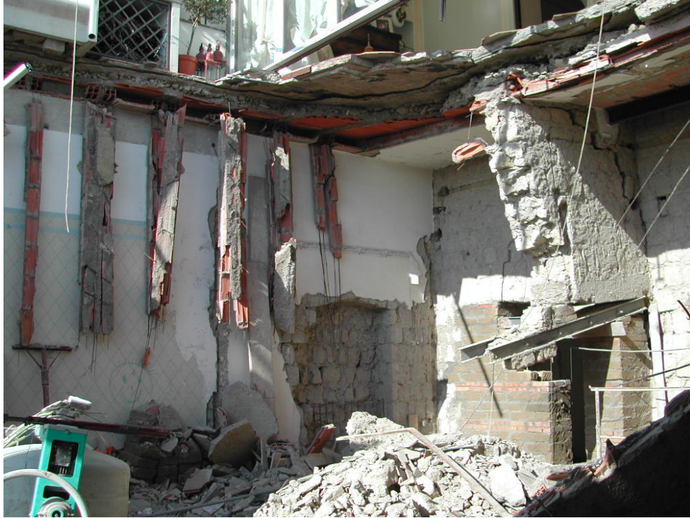
Figura 7. Il solaio e il muro trasversale crollati
