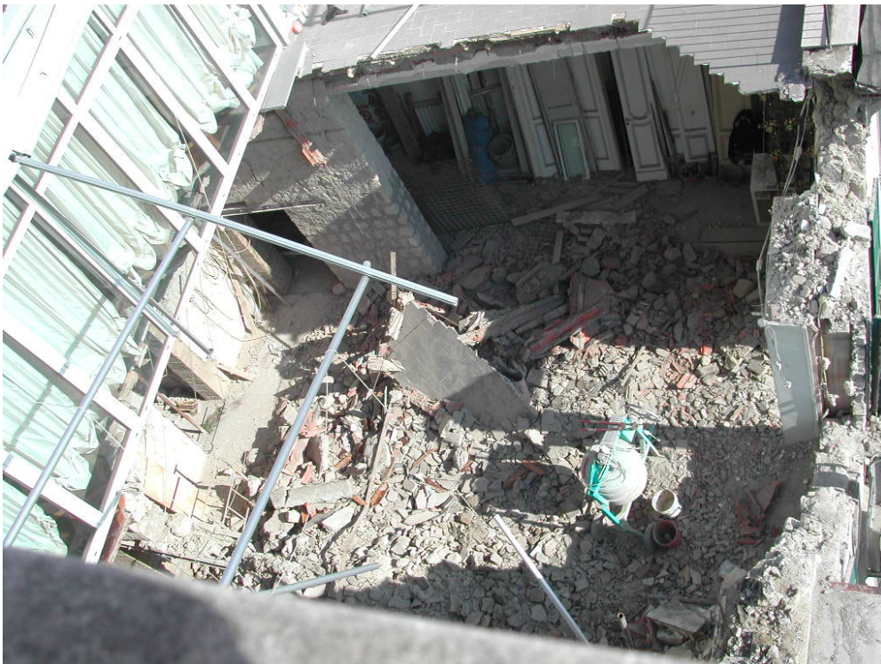
Figura 5. Il solaio crollato, visto dall'alto.
