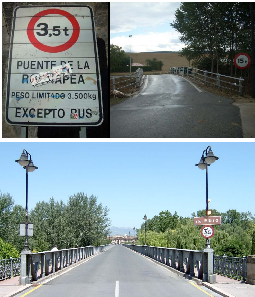
Fig. 1. La foto superior izquierda es un ejemplo de limitación que difícilmente se entiende desde un punto de vista de seguridad estructural. La foto superior derecha, correspondiente a un puente de fábrica con tablero ensachado, recoge una señal de limitación de carga cuyo valor se ha deducido con arreglo a un criterio desconocido. La foto inferior corresponde a un puente metálico construido en 1881, para el que la limitación dispuesta (sólo 3,5 t) no obedecía a criterio alguno y provocaba que sistemáticamente se incumpliera la limitación.
