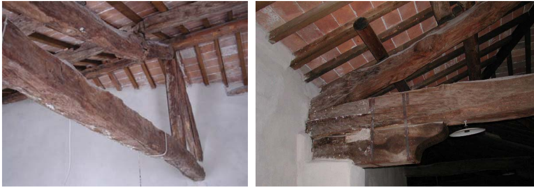
Figura 4 a, b. Elementi della struttura lignea con deformazioni e difettosità accentuate.
