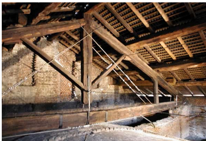
Figura 15. Intervento di consolidamento degli appoggi e delle capriate mediante cavi esterni post tesati, con inserimento di un nuovo puntello ligneo di contrasto della falda
