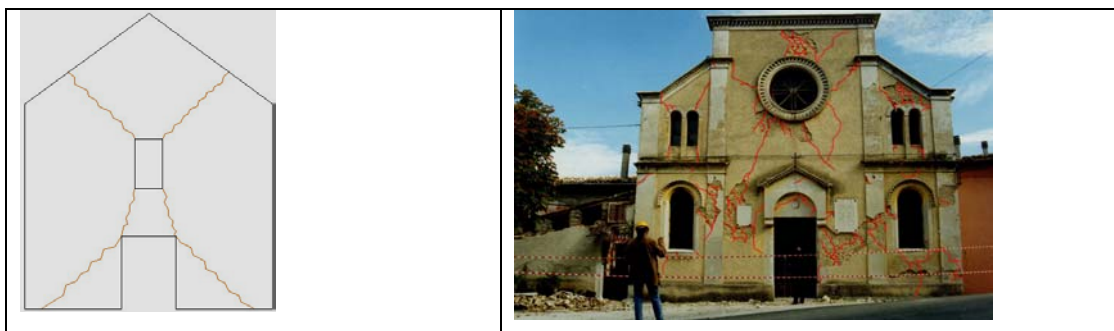
Figura 5: macroelemento facciata. Immagine fotografica riferita ad una chiesa danneggiata dal terremoto dell'Umbria nel 1997
