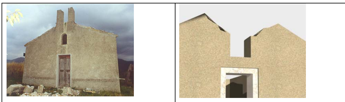
Figura 11: macroelemento timpano con campanile a vela. Immagine fotografica e rappresentazione del danno riferite ad una chiesa danneggiata dal terremoto dell'Umbria nel 1997
