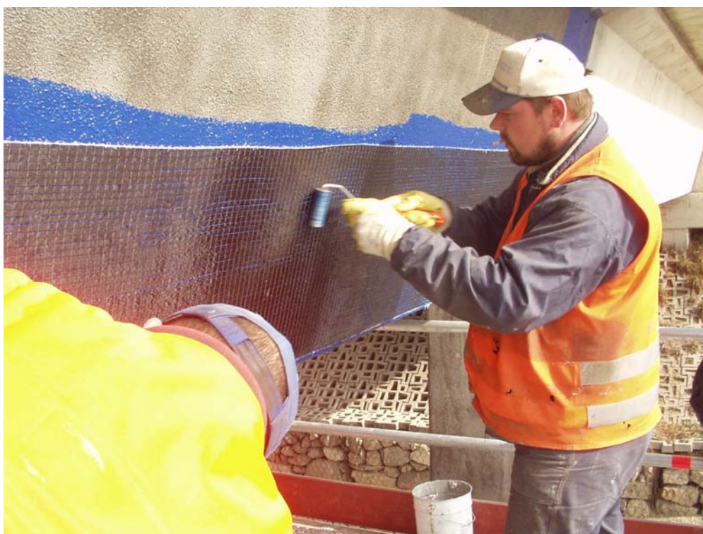
Fig. 5: Applicazione delle fibre di carbonio sulla trave di un viadotto della Autostrada del Brennero
