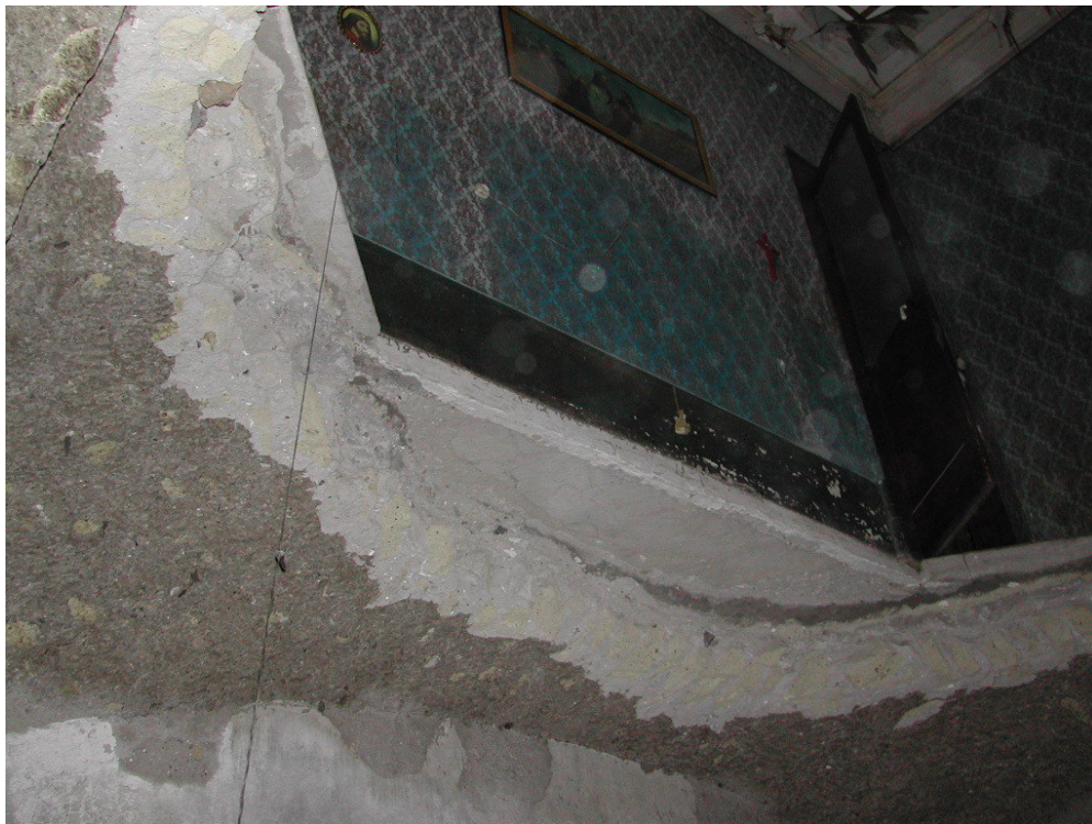
Figura 5. Particolare delle superfici di distacco
