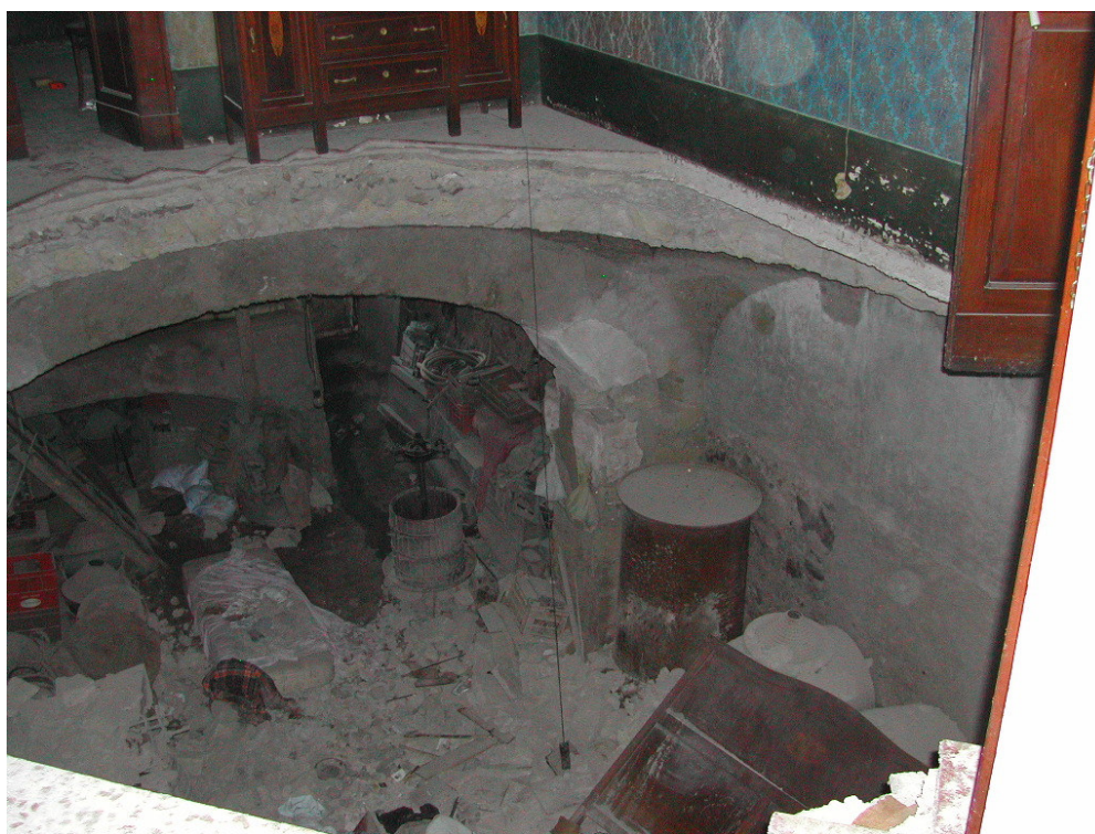
Figura 7. Vista dall'alto della volta crollata
