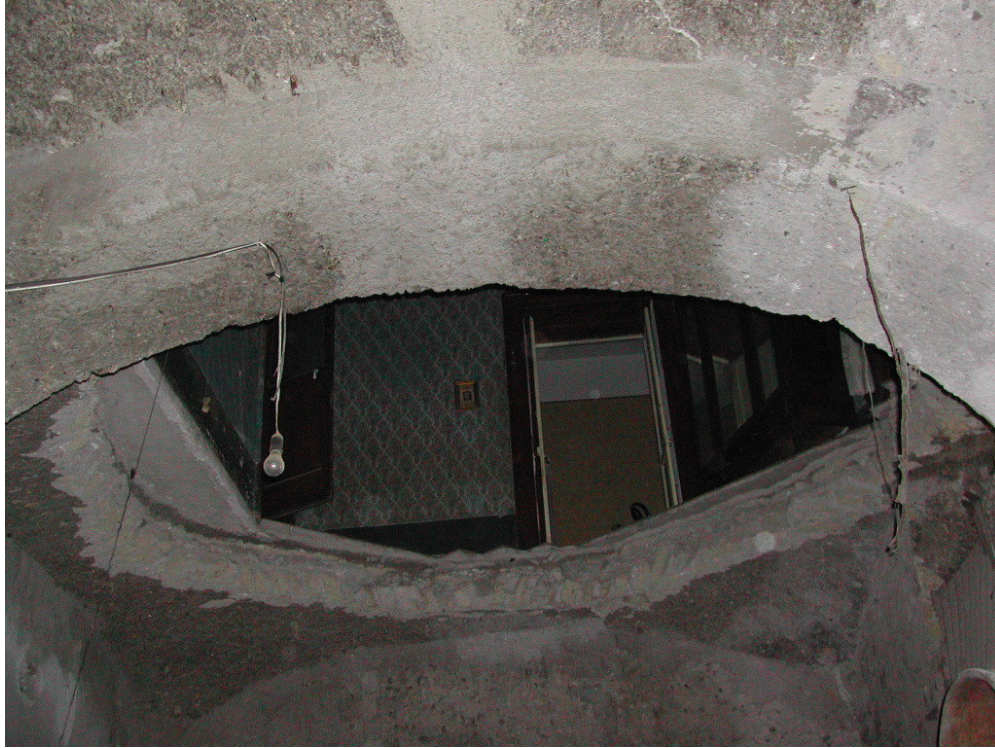
Figura 4. Vista d'insieme dal basso della zona crollata
