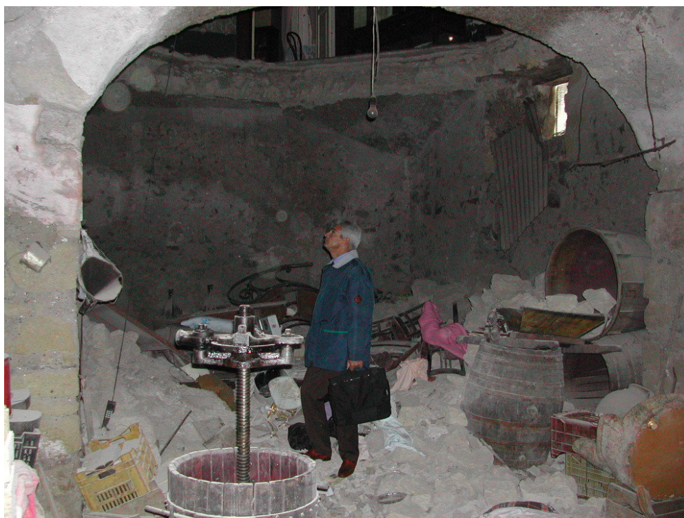
Figura 3. Ambiente cantinato nel quale è precipitata la volta nel corso del primo accesso
