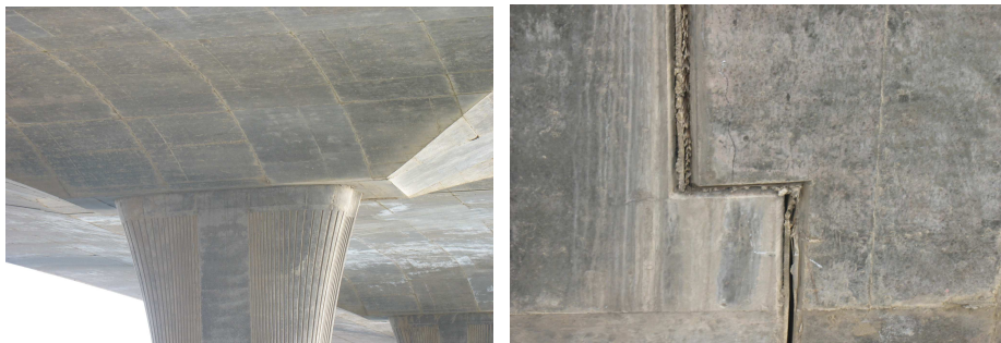
Fig. 27: Foto del profilo in prossimità della pila e della sella Gerber dall’intradosso dell’impalcato
