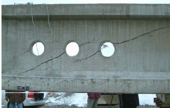
Figura 15: Fenditura di taglio che attraversa i fori circolari
