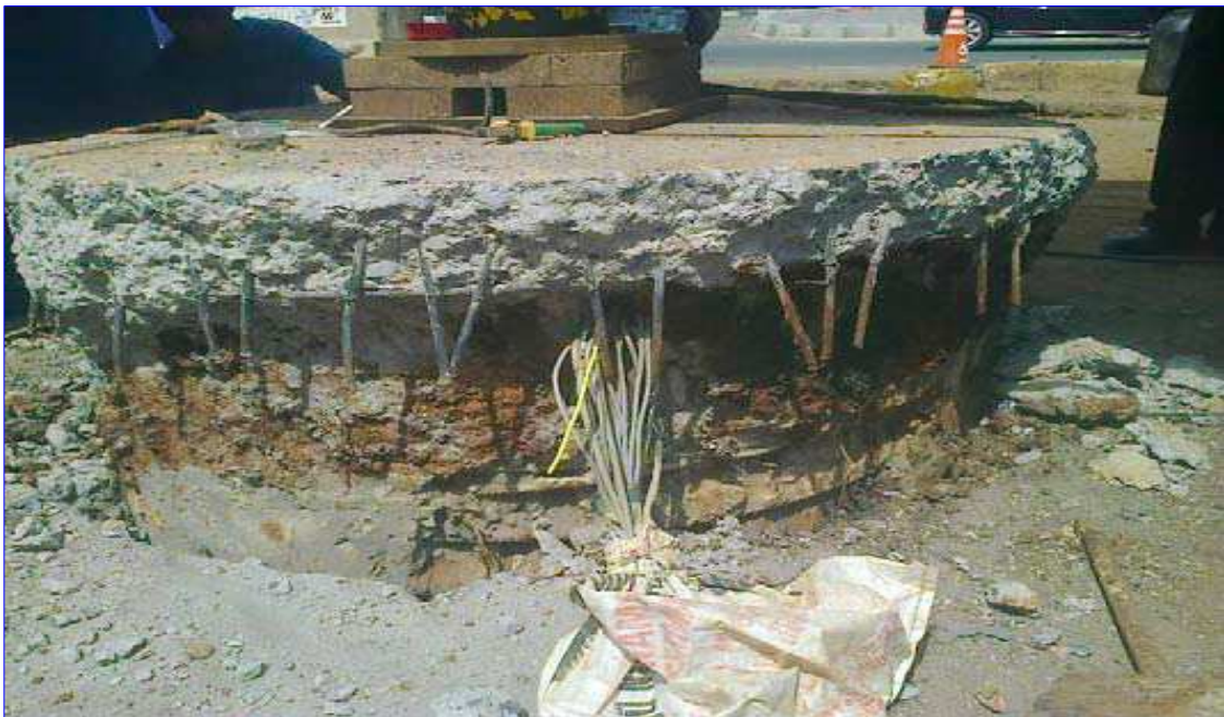
Fig. 13: Palo scavato per mettere in luce il difetto
