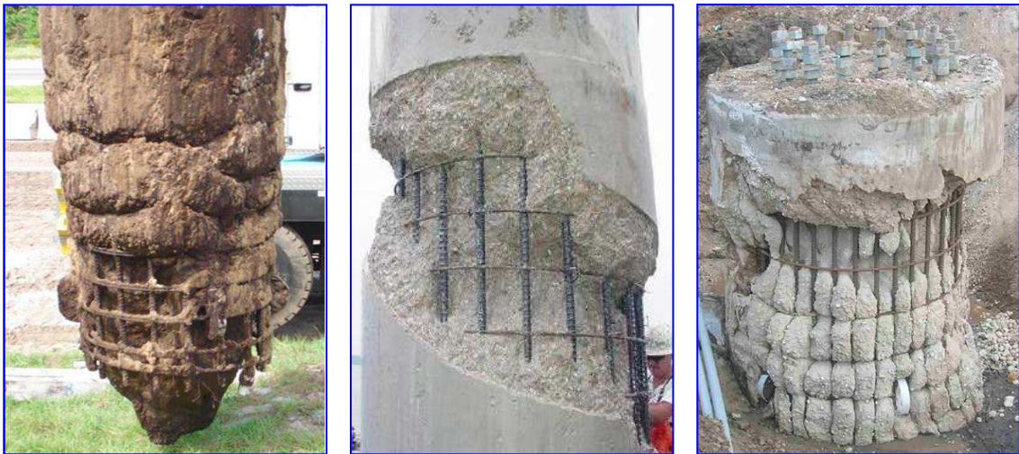
Fig. 1: Esempi di difetti tipici dei pali di fondazione riscontrabili col metodo TIP
