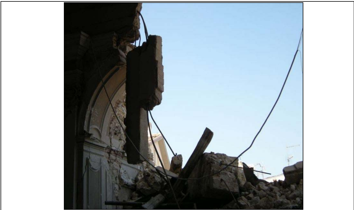
FIG. 12 – Cordolo in calcestruzzo armato partecipe dei meccanismi di collasso
