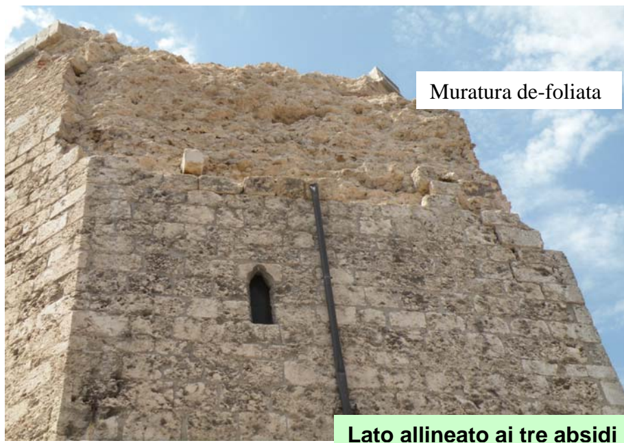
FIG. 5 – Piano inclinato formatosi per muratura defoliata sotto la cella campanaria di S. Pietro di C. 3) Intervento di presidio post-sisma funzionale alla ricostruzione
