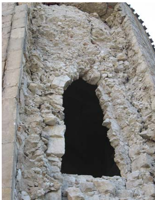
FIG. 2 - Meccanismo di “de-foliazione”: la foglia esterna della muratura è collassata. Abside di S.Eusanio Forconese AQ.
