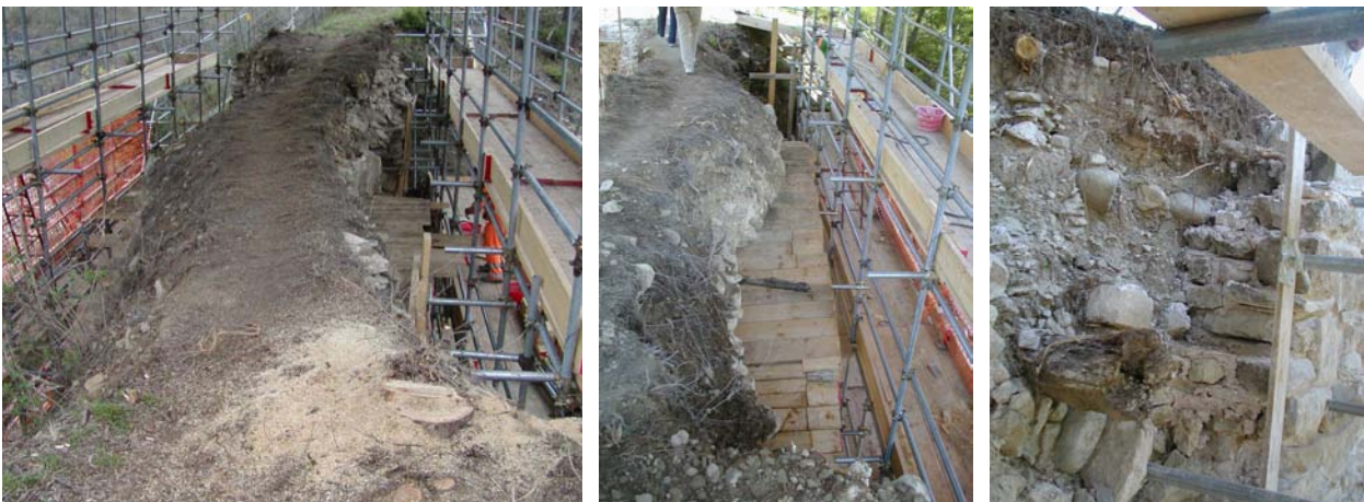
Figura 35. Immagini di cantiere: situazione precedente agli interventi di ricostruzione delle porzioni crollate di volta e di muri di testa.
