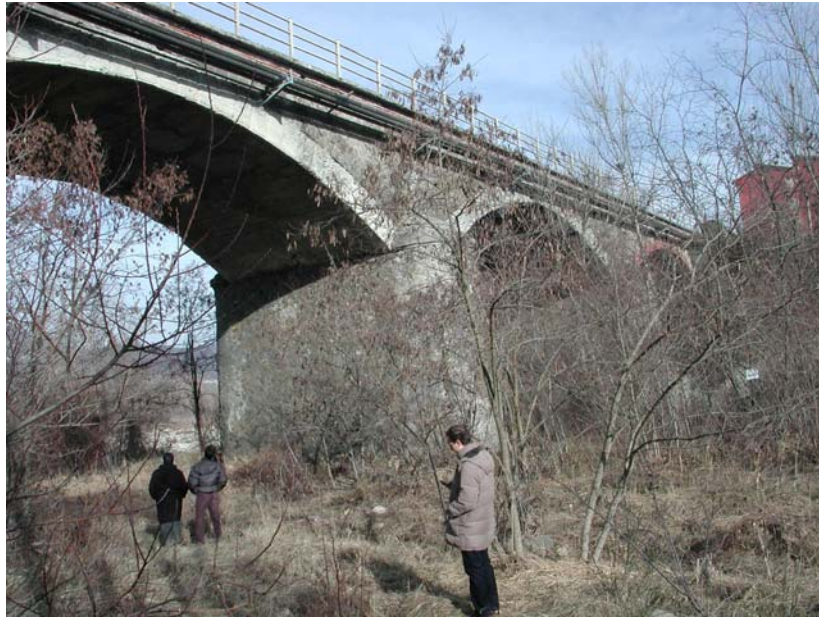
Figura 37: Ponte Locatelo. Il ponte richiede l'allargamento della carreggiata. Un intervento di adeguamento statico è necessario per supportare l'allargamento. Il ponte richiede anche l'adeguamento sismico.
