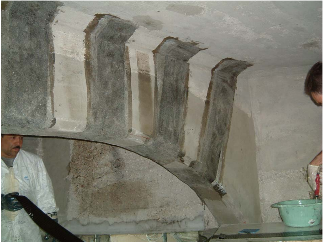
Figura 15.e: Rinforzi radiali della II fase, atti ad incrementare la portanza a taglio. Preparazione delle superfici di cls ed applicazione dei nastri.
