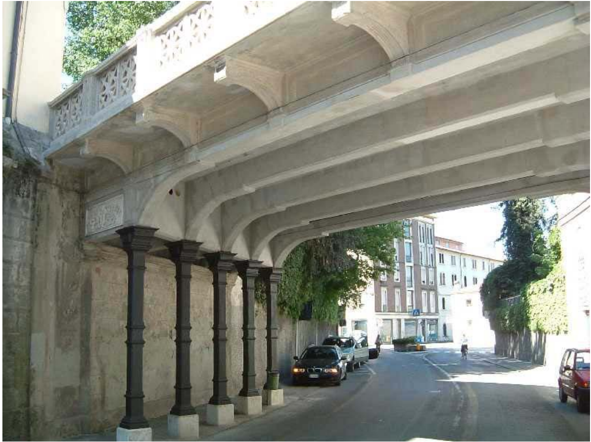
Figura 15.h: Vista del ponte ad intervento finito. La ricostituzione delle sezioni ha riportato il ponte nella sua condizione estetica primigenia. Si noti in particolare l'assenza di tracce rivelatrici della presenza dei rinforzi.
