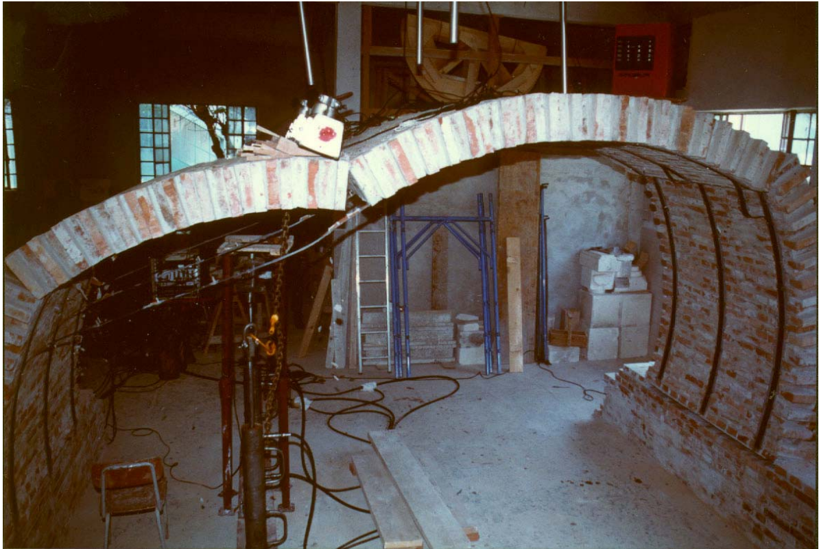
Figura 24.b: La crisi di portanza in condizioni rinforzate è avvenuta per decorticazione della muratura, come appare chiaramente dalla fotografia. La decorticazione ha compromesso l'aderenza del rinforzo. Staccatosi il rinforzo, si è formata quella cerniera la cui nascita era stata inibita dal rinforzo stesso. Tale cerniera ha reso possibile il completamento del meccanismo a 4 cerniere di Fig. 6, il quale ha condotto l'arco al collasso. S'intende che la portanza ultima non è stata dettata dal predetto meccanismo asimmetrico a 4 cerniere, che sarebbe debole. Tale meccanismo ha solo governato il crollo. La portanza ultima, e quindi la rottura, sono invece state dettate dal ben più resistente modo di crisi per decorticazione. Come tale, la portanza attinta dal ponte è stata elevatissima, laddove senza rinforzi la portanza era risultata modesta.
