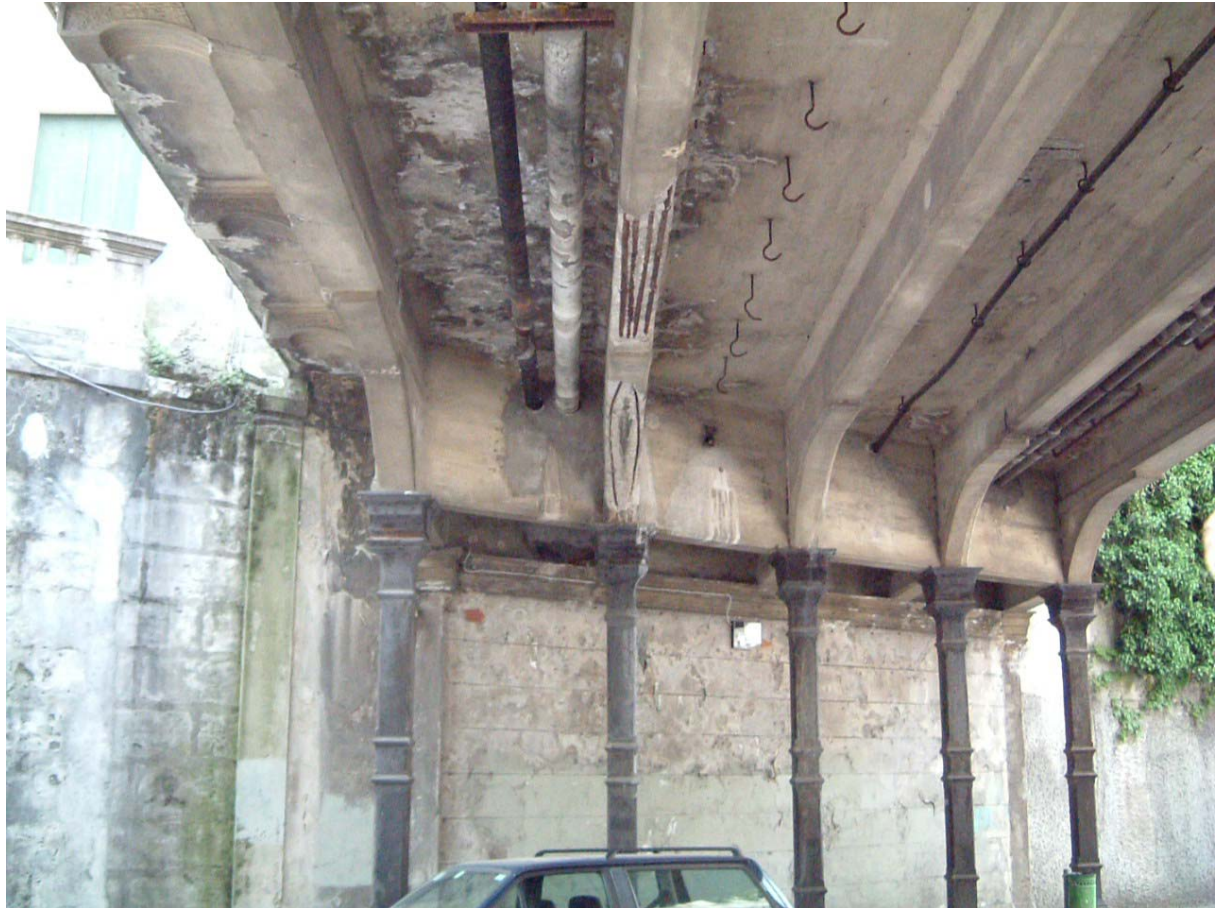
Figura 15.b: Vista intradossale dell'impalcato. Le barre delle zone curve, strombate, sono uscite dalla sede, distaccandosi dalla sezione, logica conseguenza dell'infelice progettazione delle armature. Il cls, in talune regioni corticali è carbonatato, in altre è inumidito. Il ponte presenta inoltre estesi e profondi quadri fessurativi. Alcuni sono dovuti al ritiro (getto della soletta posteriore al getto delle travi), altri derivano da coazioni termiche, altri ancora sono stati prodotti dai carichi. Sono state eseguite misure in situ della resistenza a schiacciamento del cls (rottura a compressione di carote, prove di pull-out, battute sclerometriche). I risultati delle prove ascrivono il cls alla classe C 17/20. Il calcolo deve quindi assumere, per il cls dell'impalcato: R_{ck} = 21.2 \text{ N/mm}^2 .
