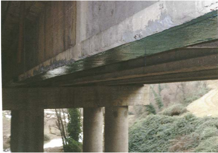
Figura 13.1: Impalcato di un ponte autostradale in C.A. adeguato mediante rinforzi in materiale composito. L'intervento è stato eseguito nel 1997. Trattasi quindi, in Italia, di un intervento pilota.
