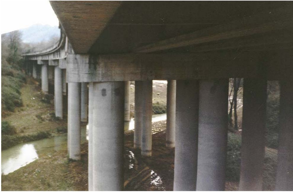
Figura 13.3: Vista di un ponte autostradale. La portanza dell'impalcato non poteva portare in sicurezza il sovrappeso dato dall'adeguamento delle barriere di protezione laterale. L'impalcato è stato adeguato ai nuovi carichi permanenti incollando un'armatura esterna in composito.
