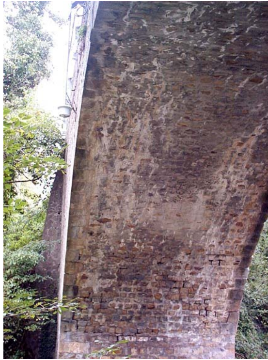
Figura 41: Altro ponte sulla SP 60. Il ponte è stato adeguato funzionalmente. L'adeguamento nunzionale ha richiesto l'adeguamento statico e sismico. L'intervento è stato improntato in composito.
