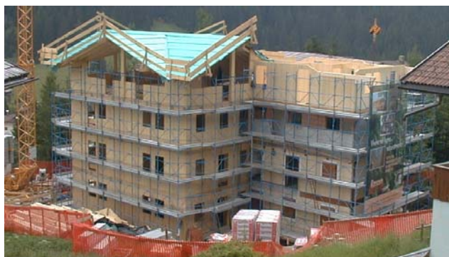
Figura 1. Edificio a struttura di legno di 4 piani realizzato con il sistema XLam (per gentile concessione della RASOM Holz&Ko).
