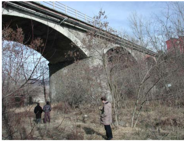
Figura 11-a. Ponte sito nell'Appennino emiliano, gestito dal Settore Viabilità della Provincia di Bologna, da allargare e adeguare.
