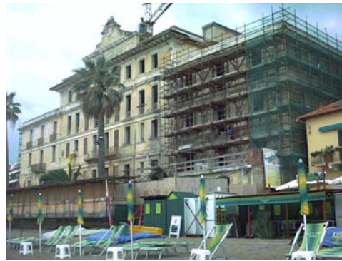
Figura 14- a . Grand Hotel di Alassio. Le strutture sono in muratura di mattoni. La facciata è costituita da mattoni a 6 o a 8 fori (di diametro notevole). Vale a dire, i mattoni sono largamente forati sebbene essi rivestano il ruolo portante. La facciata non arriva al suolo ma si arresta al primo piano, dove poggia su una travata metallica a sua volta poggiata su pilastri in ghisa.
