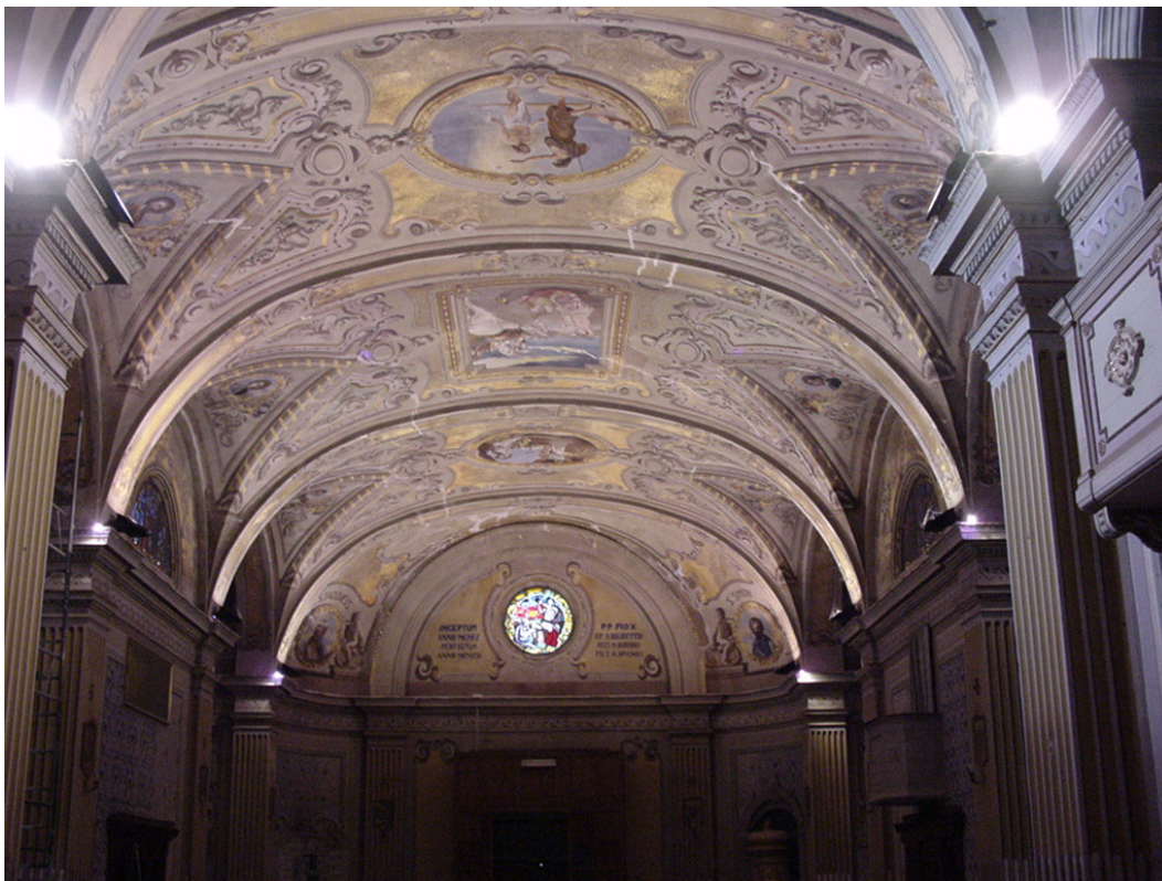
Figura 13-a. Una volta del sistema strutturale voltato era profondamente fessurata.
