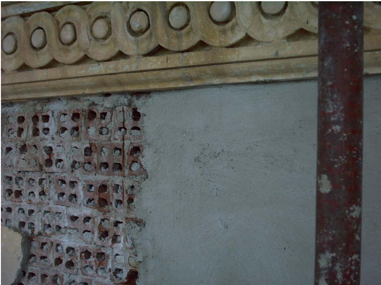
Figura 14- b . Alcuni eventi avevano fessurato profondamente ed estesamente la facciata. La fessurazione aveva decoeso il paramento, il quale consisteva in frammenti di placche. Il paramento era a malapena in grado di portare i pesi propri e quindi non era in grado di portare in sicurezza le altre azioni. L'immagine fotografica mostra altresì la geometria dei mattoni. Se ne osserva la cospicua foratura.
