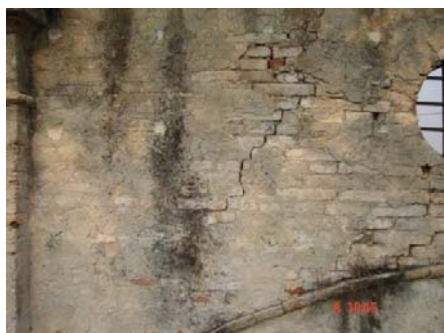
Figura 4.4. Fessura prospetto Sud
