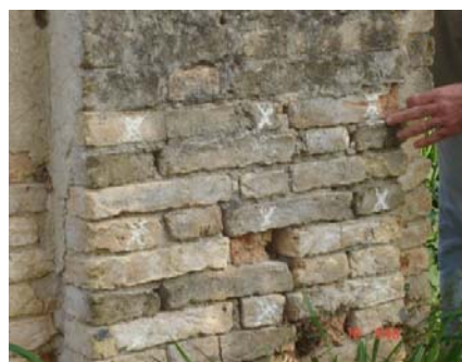
Figura 4.5. Fessura di un pilastro prospetto Sud
