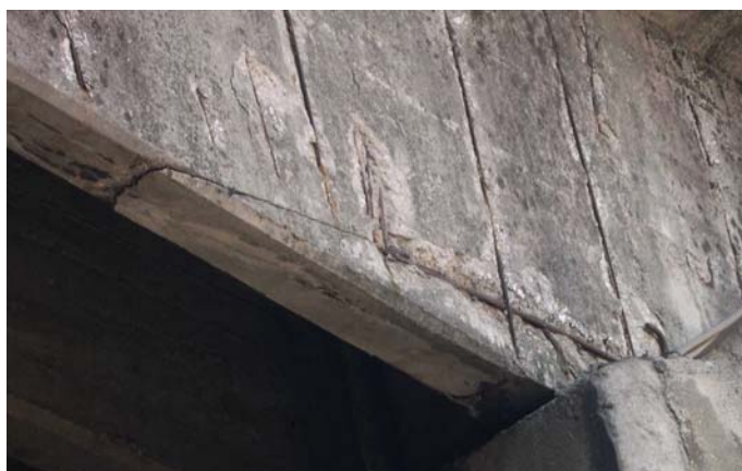
Fig. 4: Vista del distacco del copriferro causato dalla spinta delle barre
