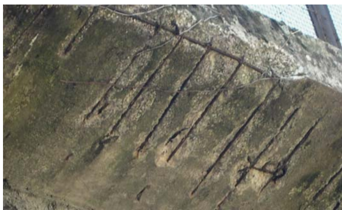
Fig. 3: Vista del degrado delle solette degli sbalzi esterni
