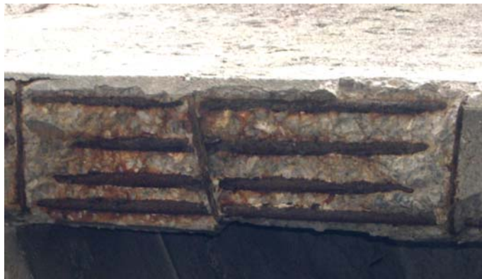
Fig. 2: Vista della corrosione delle armature principali delle travi esterne
