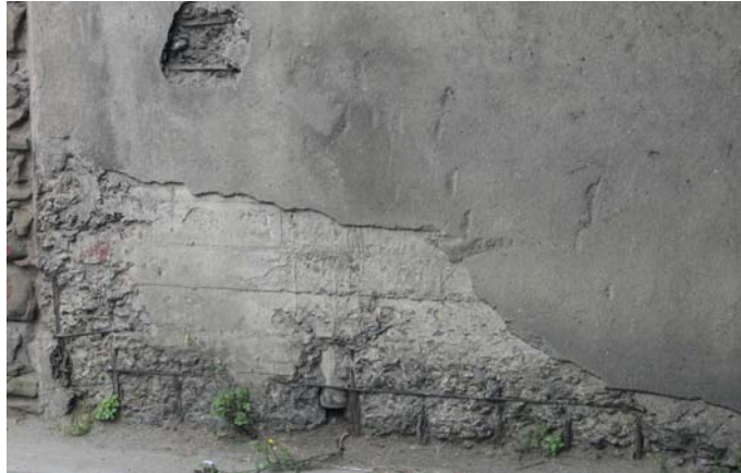
Fig. 5: Vista del degrado al piede della parete in calcestruzzo che funge da pila
