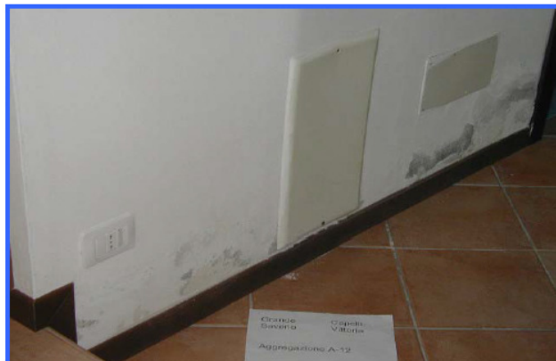
Figura 8 Estratto dal test report – evidenza della presenza dell’umidità – confronto visibile/IR (la parete è un divisorio interno, il muro perimetrale a Nord è a destra, nella foto, oltre alla porta)
