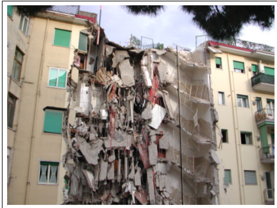
Fotografia 2. La parte alta del crollo
